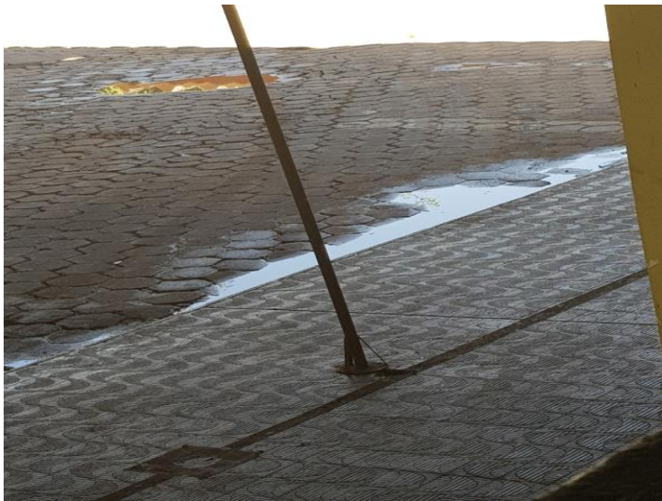
Imagem 19: Asfalto esburacado. Fonte: Elaborada pelo autor.
