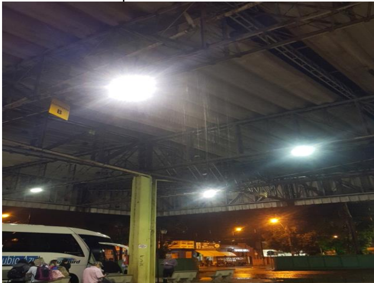
Imagem 16: Água caindo do telhado. Fonte: Elaborada pelo autor.
