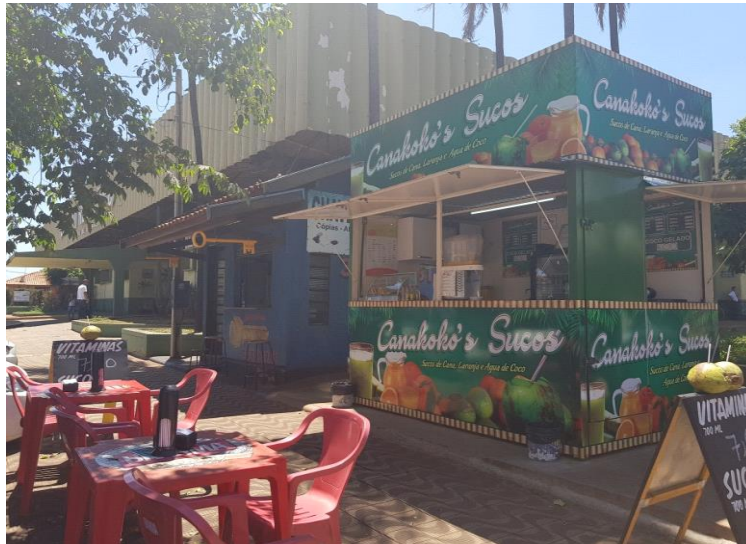
Imagem 21: Pintura descascada. Fonte: Elaborada pelo autor.
